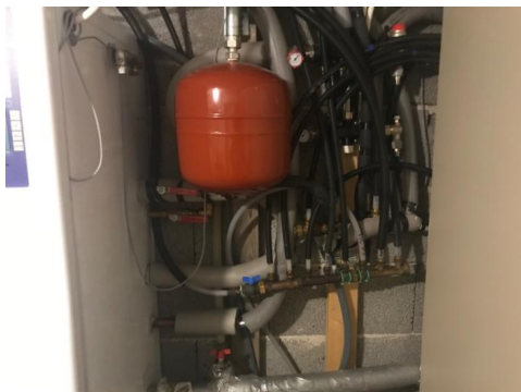
Varmerør og ekspansjonstank.
