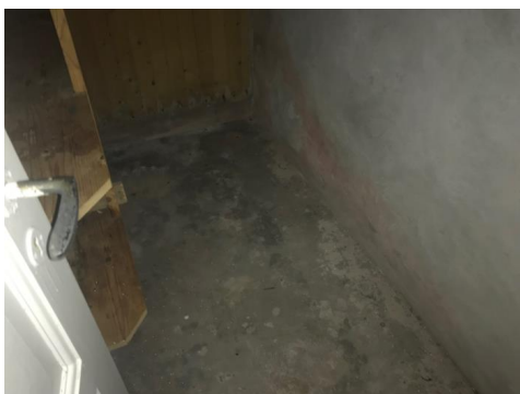
Det er noe fugt skjolder i boder i kjeller
